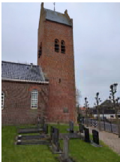
De kerktoren van Gauw. Links met steigergaten en rechts na het dichtmaken van de steigergaten.
